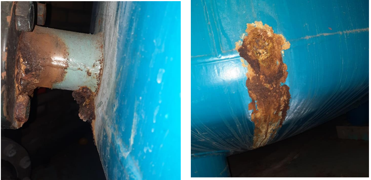
Figuur 1 Roestvorming zandfilters
