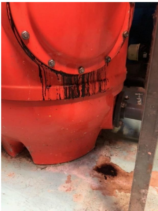
Figuur 2 Ureumfilter lekkages
