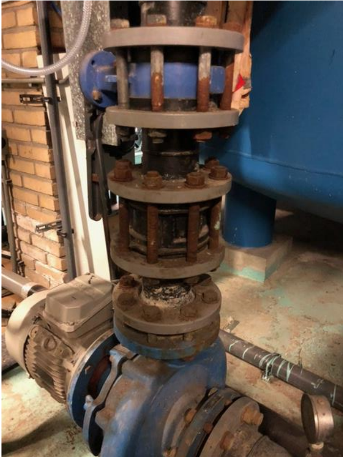
Figuur 3 Pompgroep zandfilter
